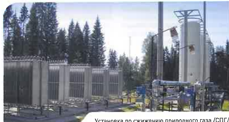
Установка по сжижению природного газа /СПГ/
